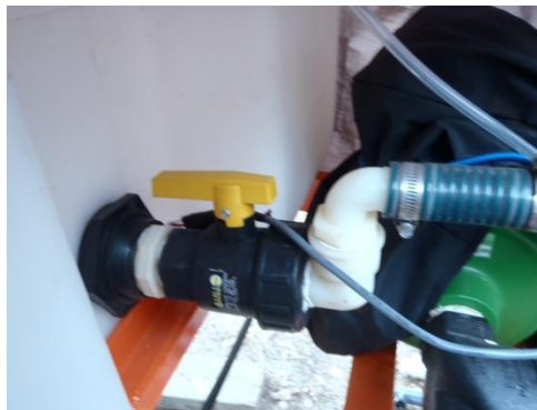
Fill valve in fill position
